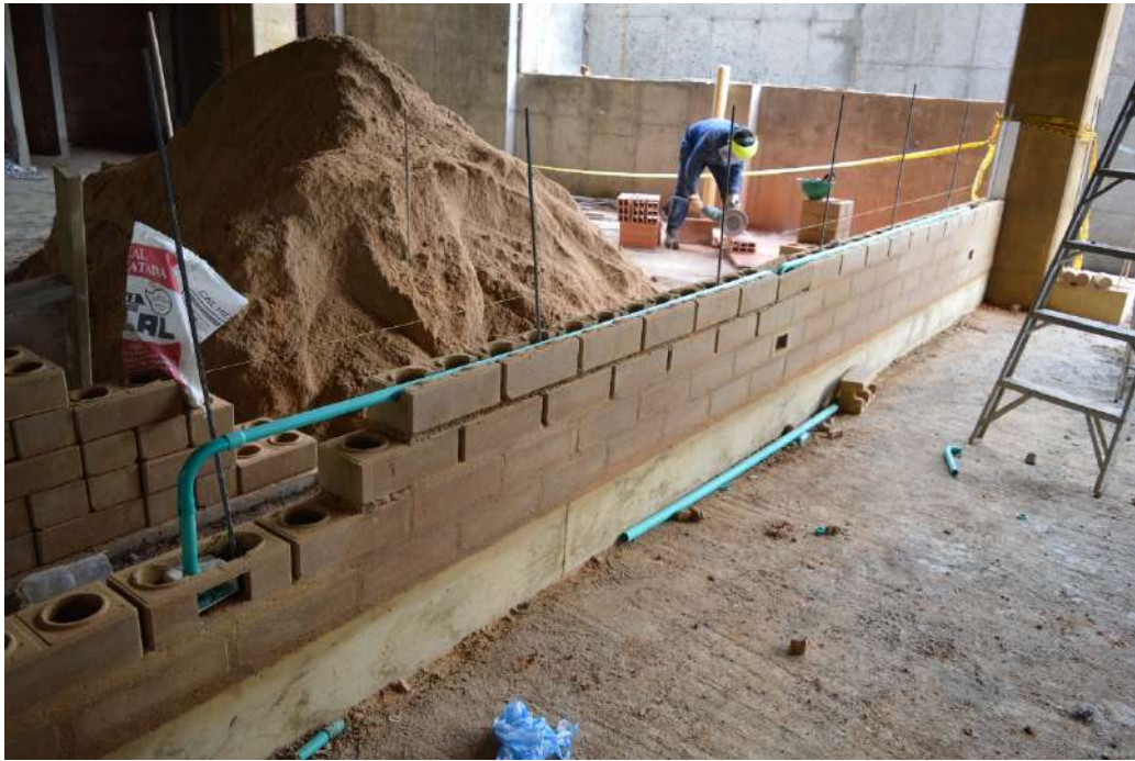
Fig. 8 | Parete in BTC sagomati per il passaggio degli impianti e delle armature. (UIS, 2019).
